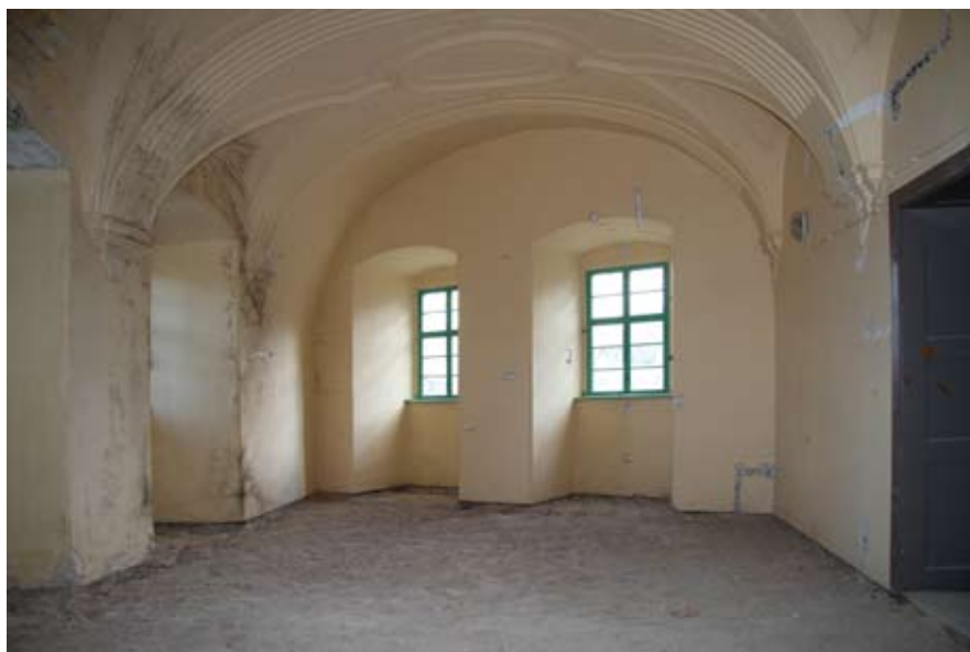
Fot. 1. Jedna z sal obiektu poklasztorowego w Cieplicach, z bogatą sztukaterią i nieodszkodziłymi jeszcze freskami, znajdująca się w narożniku północno-wschodnim piętra (fot. A. Nowak-Odelga).
