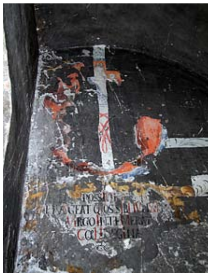
Fot. 3. Odkrywki malowideł ściennych wykonane w 2011 r. (jaśniejsze pasy). U dołu widoczne odkrywki z lat 30-tych XX w. (fot. A. Nowak-Odelga).
