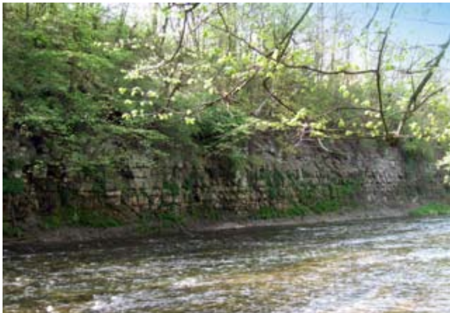
Fot. 2. Degradacja kamiennych umocnień koryta przez roślinność (fot. A. Latocha).
