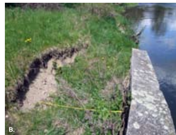
Fot. 6. A, B. Wyraźne nasilenie erozji następuje na kontakcie brzegu umocnionego z naturalnym (fot. A. Latocha).
